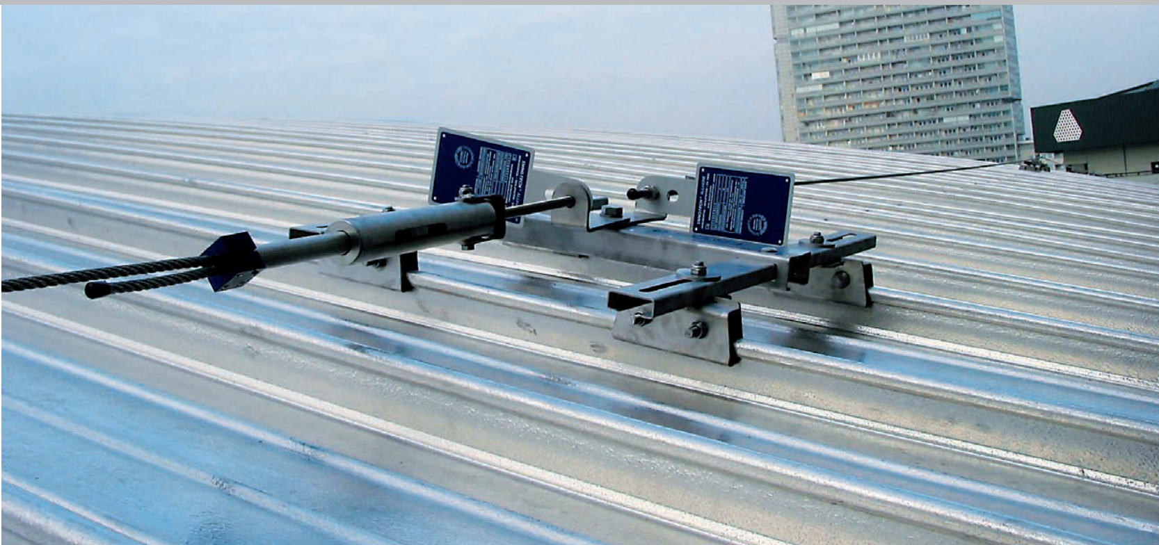
VIC Wien, Absturzsicherung auf Kalzipdach
